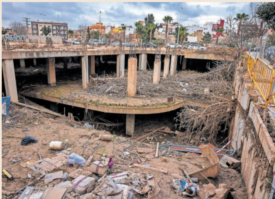
Restos de un edificio en Catarroja que fue arrasado por la dana. MÓNICA TORRES
